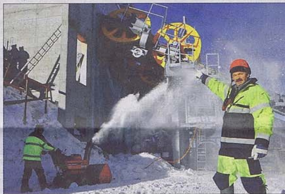
Bereits sind die Rollen für das Zugseil in der neuen Bergstation montiert.
